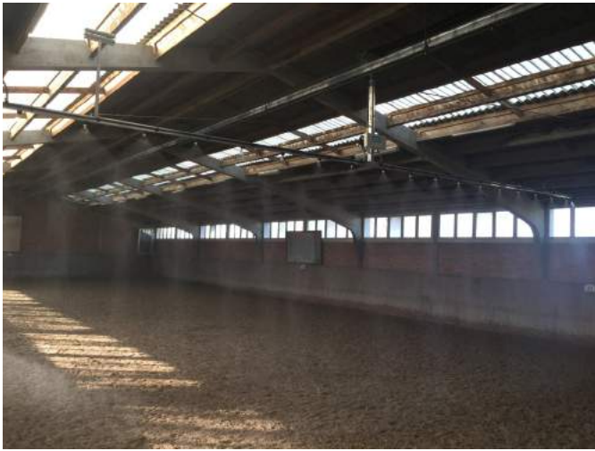
Ein feiner Sprühregen sorgt für präzise Bewässerung der Reithalle
